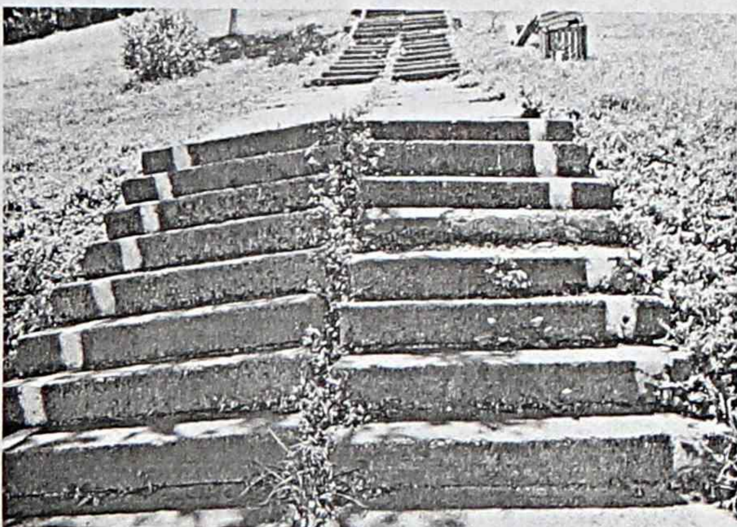
Лестничный марш к памятнику ВОВ в селе Анна от времени перекопился. Требуется реставрация
