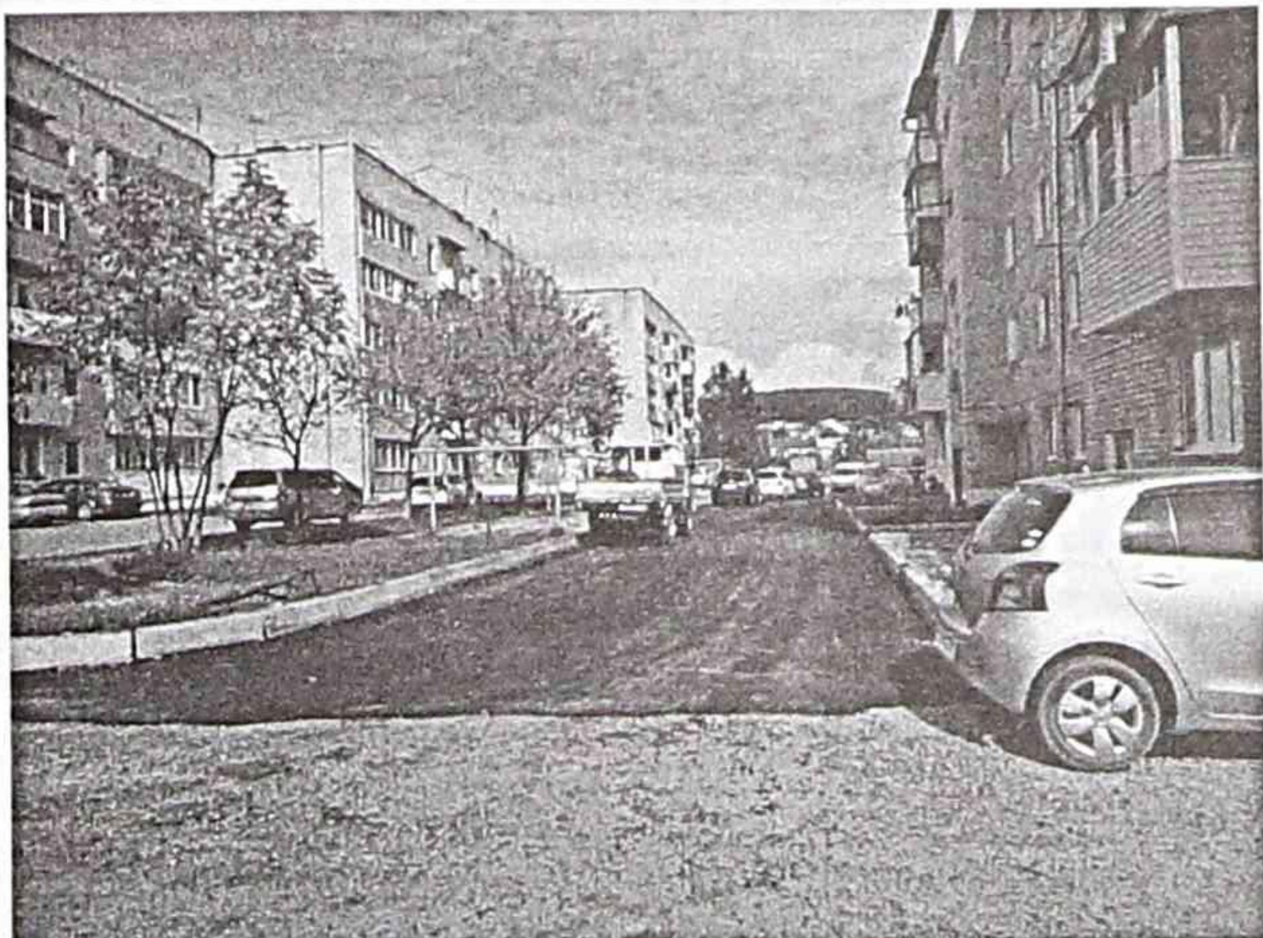
Улица Заречная 4. Положили асфальт. Установили бордюры. Улица Заречная 6. Расширили дорогу. Положили асфальт, установили бордюры. Сделали стоянку для автомобилей. Улица Заречная 5, 7, 8. Положили асфальт, установили ливнеотстоки.
